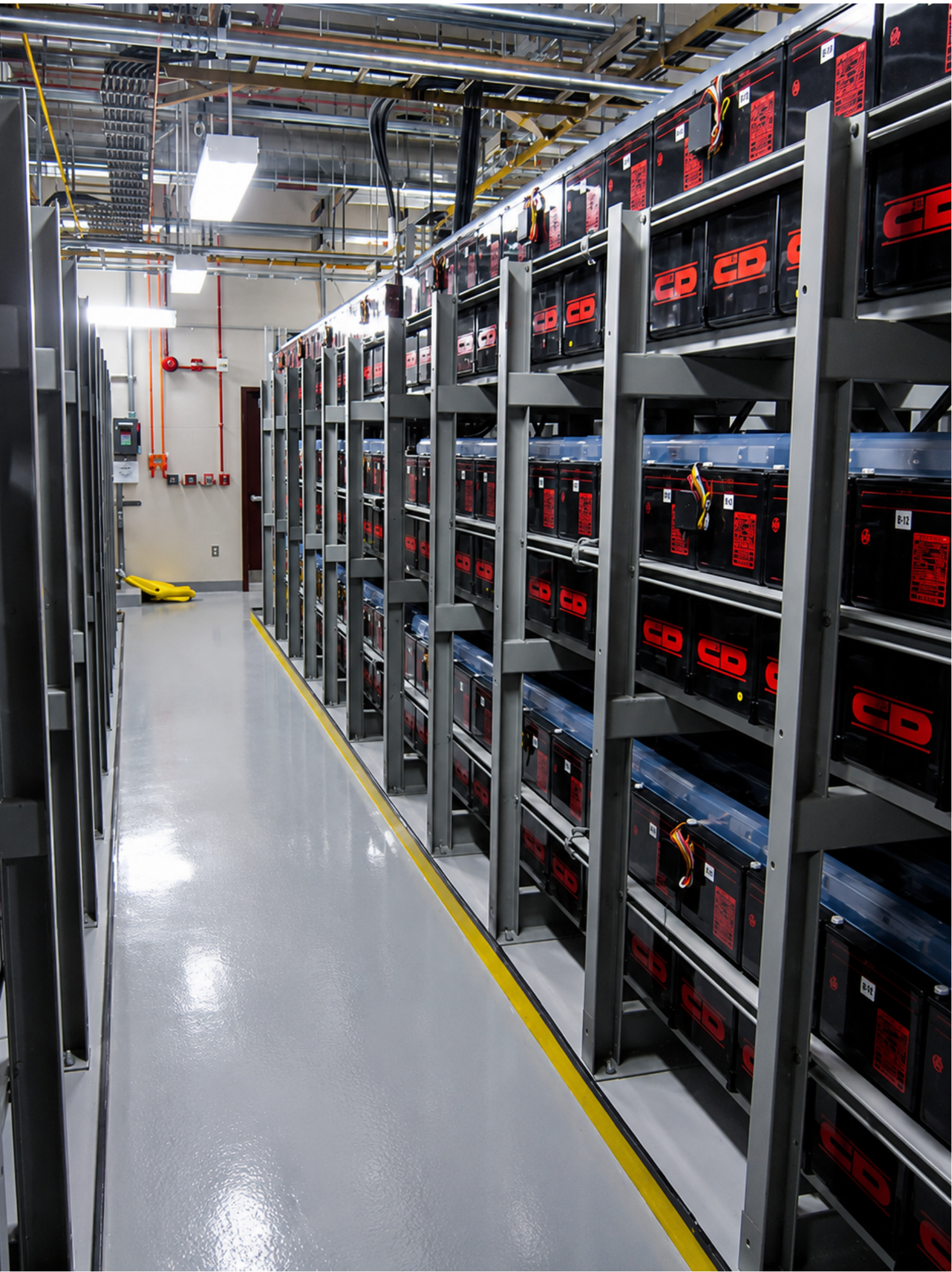
Sala de baterías (UPS). Almacenamiento energético que mantiene los servidores funcionando mientras arrancan los generadores o si hay una perturbación de la red.
